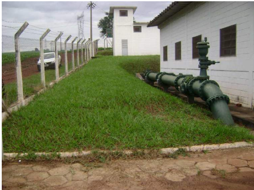
Foto 6 – Casa e Bombas do Matão
