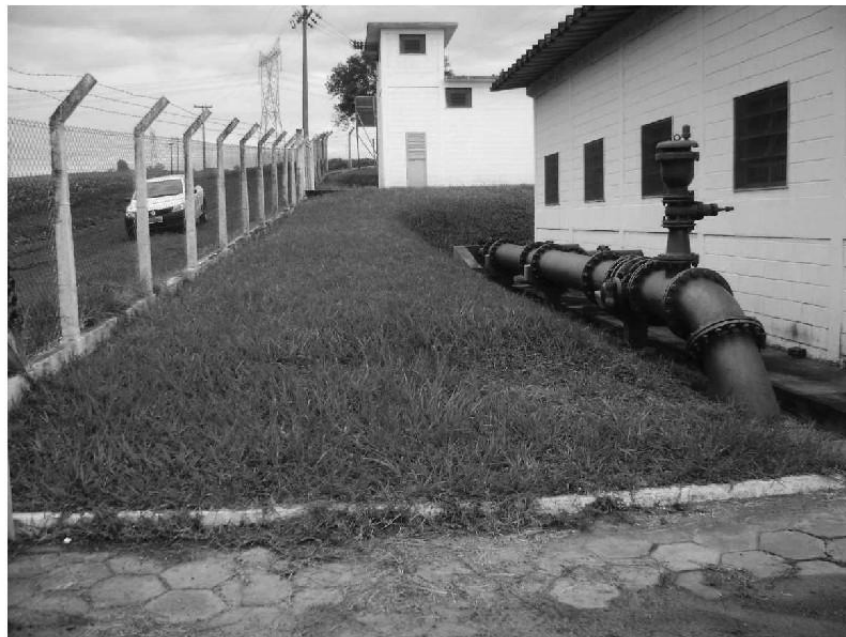
Foto 6 – Casa e Bombas do Matão
