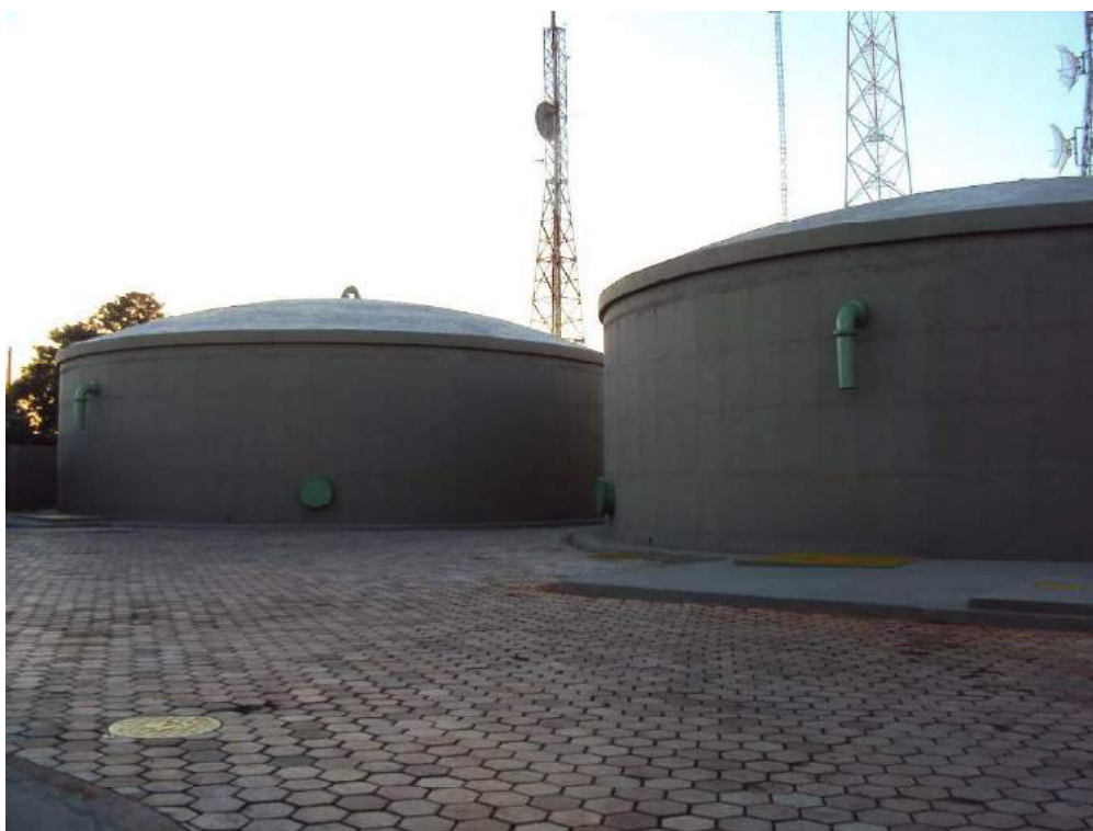
Foto 13 – Reservatório 2000m3 Vila Fiuza
