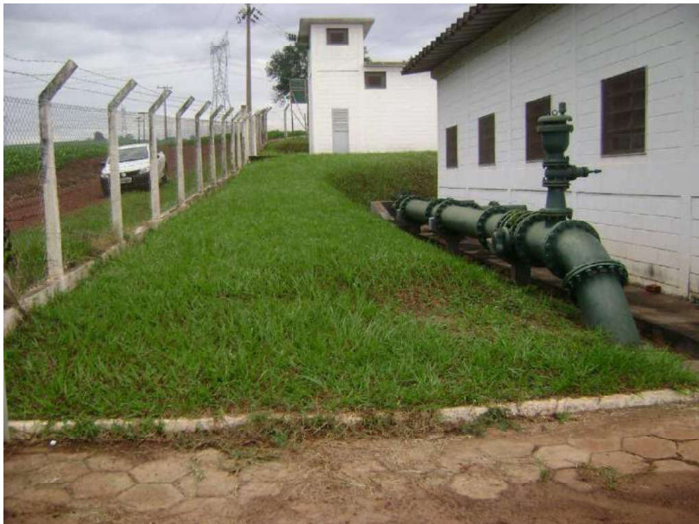
Foto 6 – Casa e Bombas do Matão
