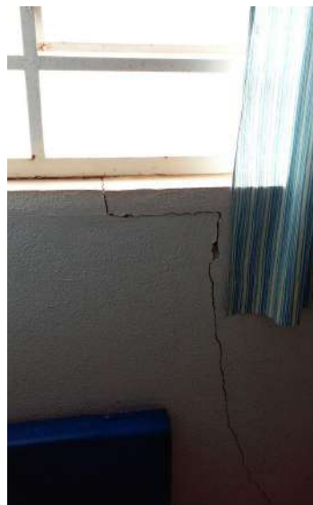
Rachaduras na sala de aula
