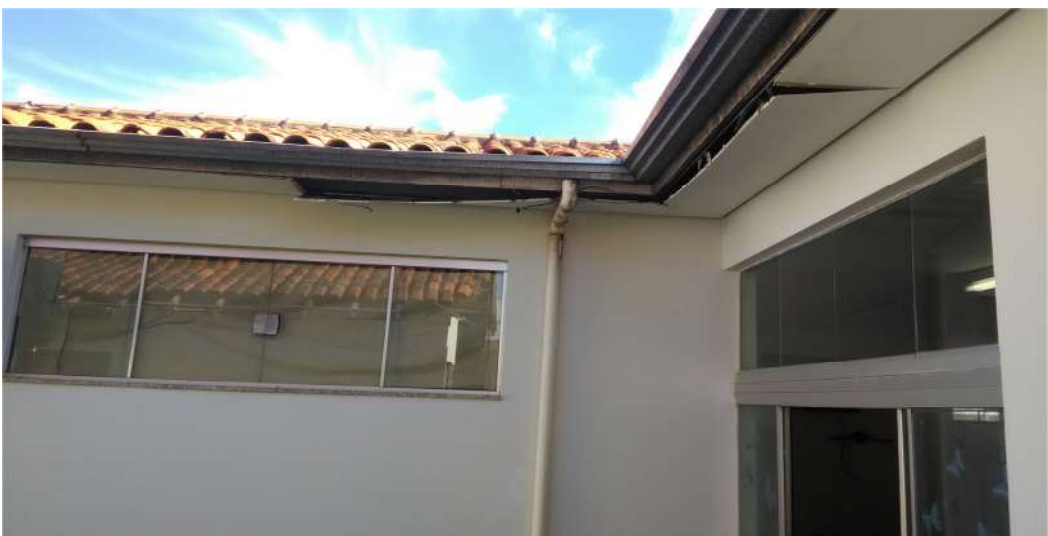
U.S.F. Jardim Eldorado: Telhado e beiral do prédio necessitando de reparos. (constatação em visita realizada em 14/05/19)
