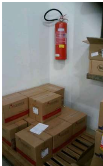
Difícil acesso do extintor
