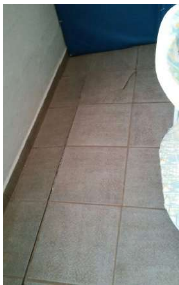
Rachaduras na sala de aula
