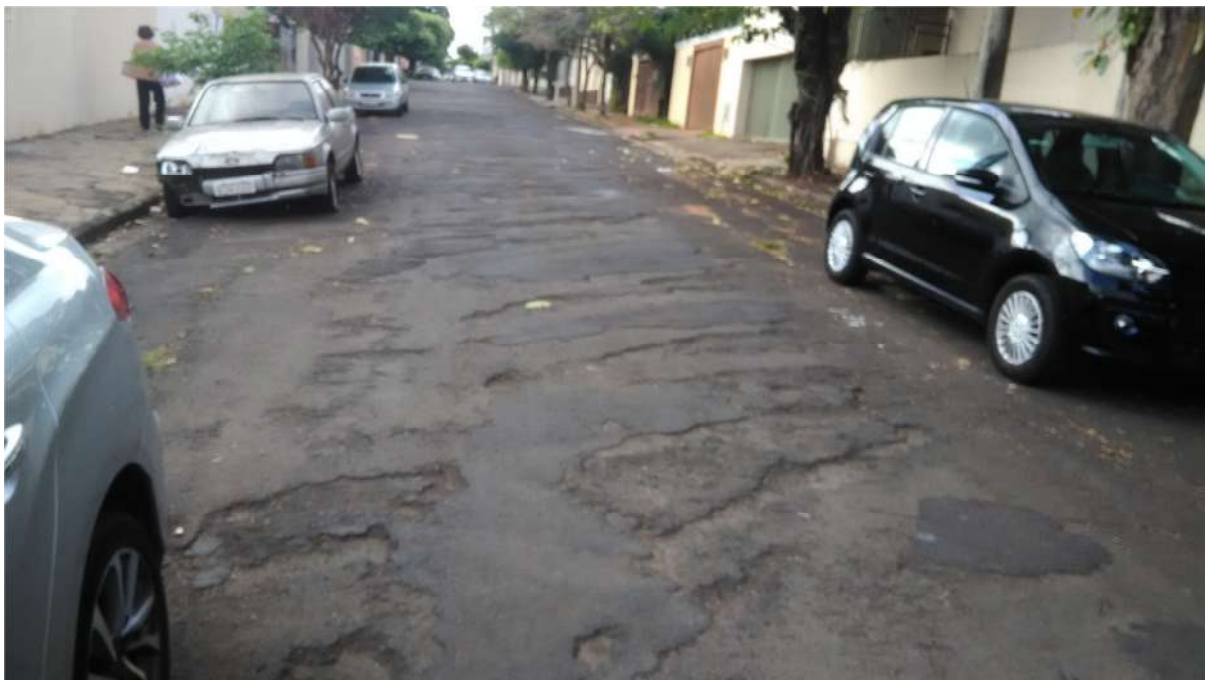
Trecho da Rua Antonio Vieira Dias necessitando de manutenção no pavimento asfáltico.
