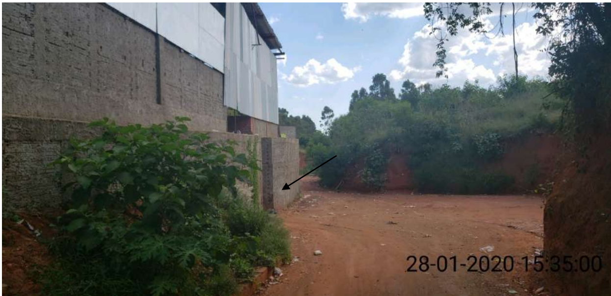
Foto 2: a parede citada com abaulamento foi devidamente dimensionada em contenção de talude para facilitar o acesso da carreta na baía de carregamento e após vistoria constatamos estabilidade do mesmo sem risco eminente de desabamento.
