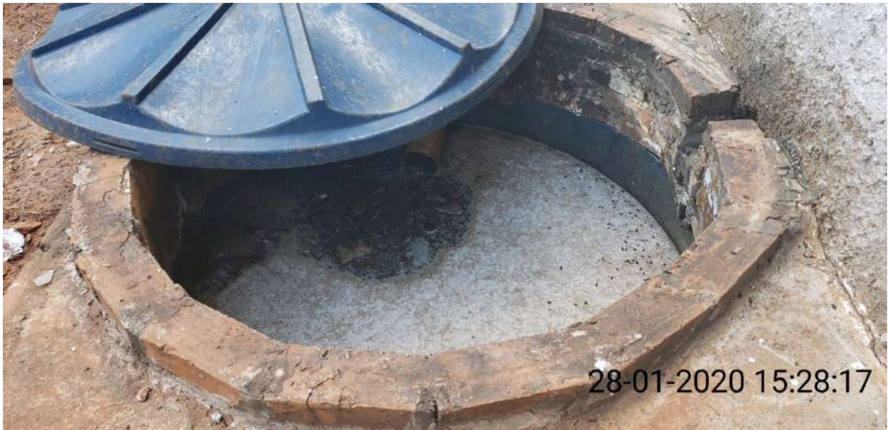
Foto 8: caixa central em funcionamento coletora de chorume. O devido destino desse material é dado pela SABESP atendo a determinação do órgão ambiental conforme ANEXO G.
