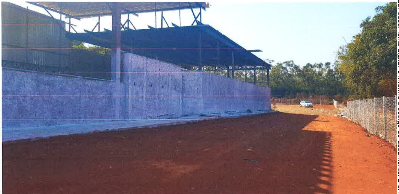
Figura 5 – Caixa de coleta de chorume da área coberta de recebimento dos resíduos sólidos urbanos.
