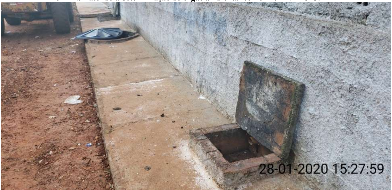
Foto 9: caixa intermediária coletora de chorume conforme determinação do órgão ambiental em funcionamento de forma adequada.
