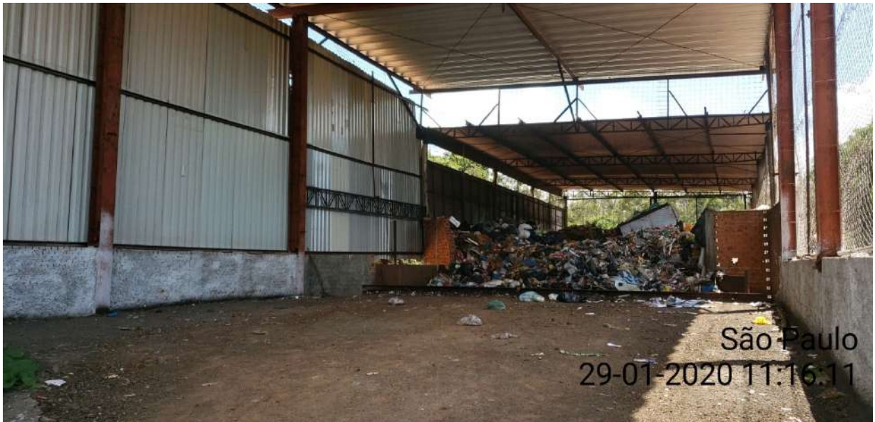
Foto 7: vista interna do depósito de RSU e baia de carregamento.
