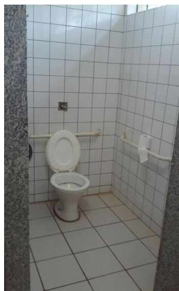
Banheiro masculino para alunos com deficiência sem porta
