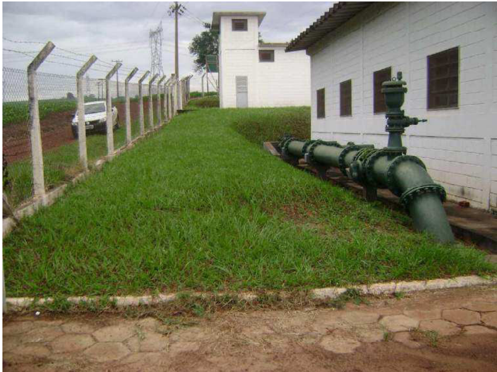
Foto 6 – Casa e Bombas do Matão
