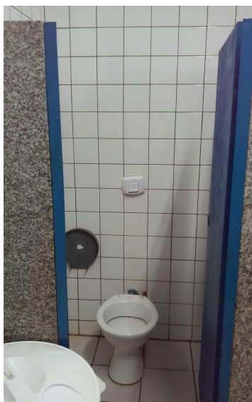
Banheiros masculinos sem porta e sem tampa nos vasos
