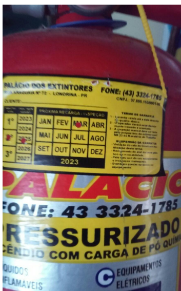
Extintores com validade ate 2025
