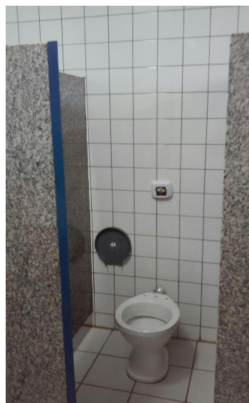
Banheiro masculino sem porta e sem tampa nos vasos
