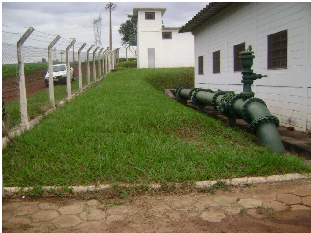
Foto 6 – Casa e Bombas do Matão
